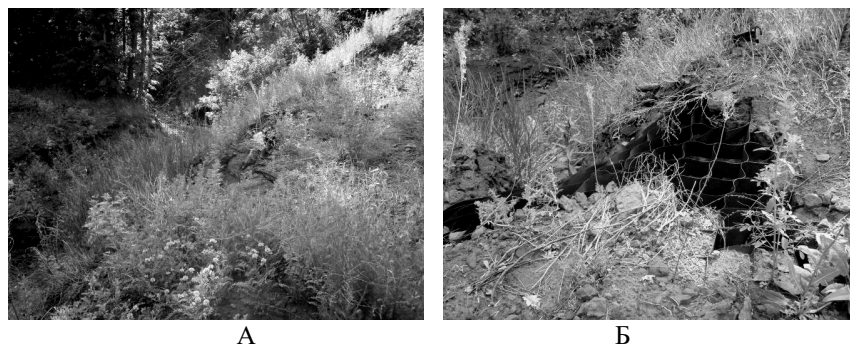
Рис. 10. А – донный врез на переходе газопровода через овраг у с. Медведицы; в центральной части снимка видны деформации георешетки в результате оплывания грунта. Б – размыв и проседание георешетки в результате линейной эрозии по выемке в нижней части правого борта оврага.
