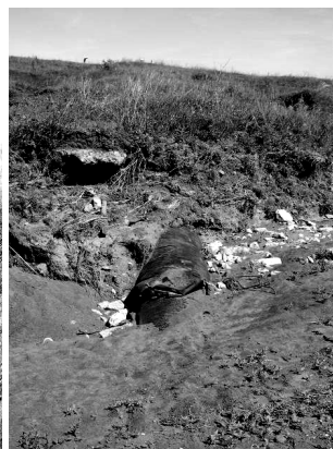
Рис. 2. Оголение действующего трубопровода в донном врезе балки Сухой Дол (устьевая часть водосборов № 11 и 12).
