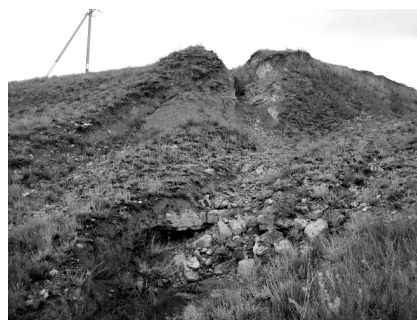
Рис. 8. Активные линейные размывы на крутом подмываемом правом коренном борту балки Каменной в коридоре трассы действующего газопровода.
