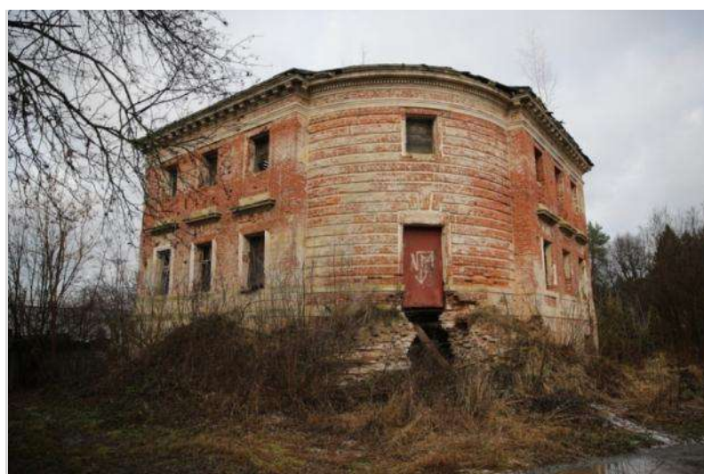
Рис. 17. Северо-Западный флигель, стена которого обрушена в том месте, где ранее располагались ступени. 66
