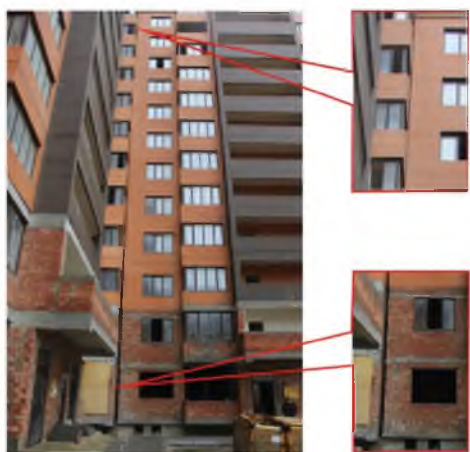
Фото 3. Представлены фрагменты деформационных швов между четвертым и третьим блоком
