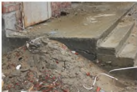
Фото 6. Просадка здания, разрыв лестничной площадки
