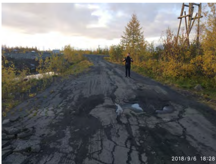
Рис. 3. Деформация дорожного покрытия в результате развития термокарста и вытаивания полигонально-жильных льдов под насыпью дороги (фотография Толманова В.А., сентябрь 2018 г.).
